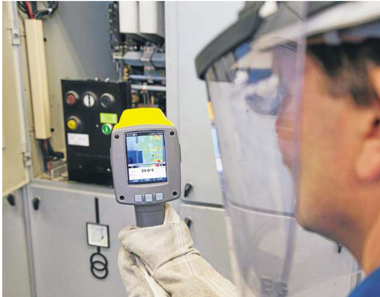
Durch eine berührungslose Messung der Wärmestrahlung können thermische Abweichungen festgestellt werden. Somit werden Schwachstellen und Fehlerquellen frühzeitig erkannt, um zum Beispiel Produktionsausfälle zu verhindern.
